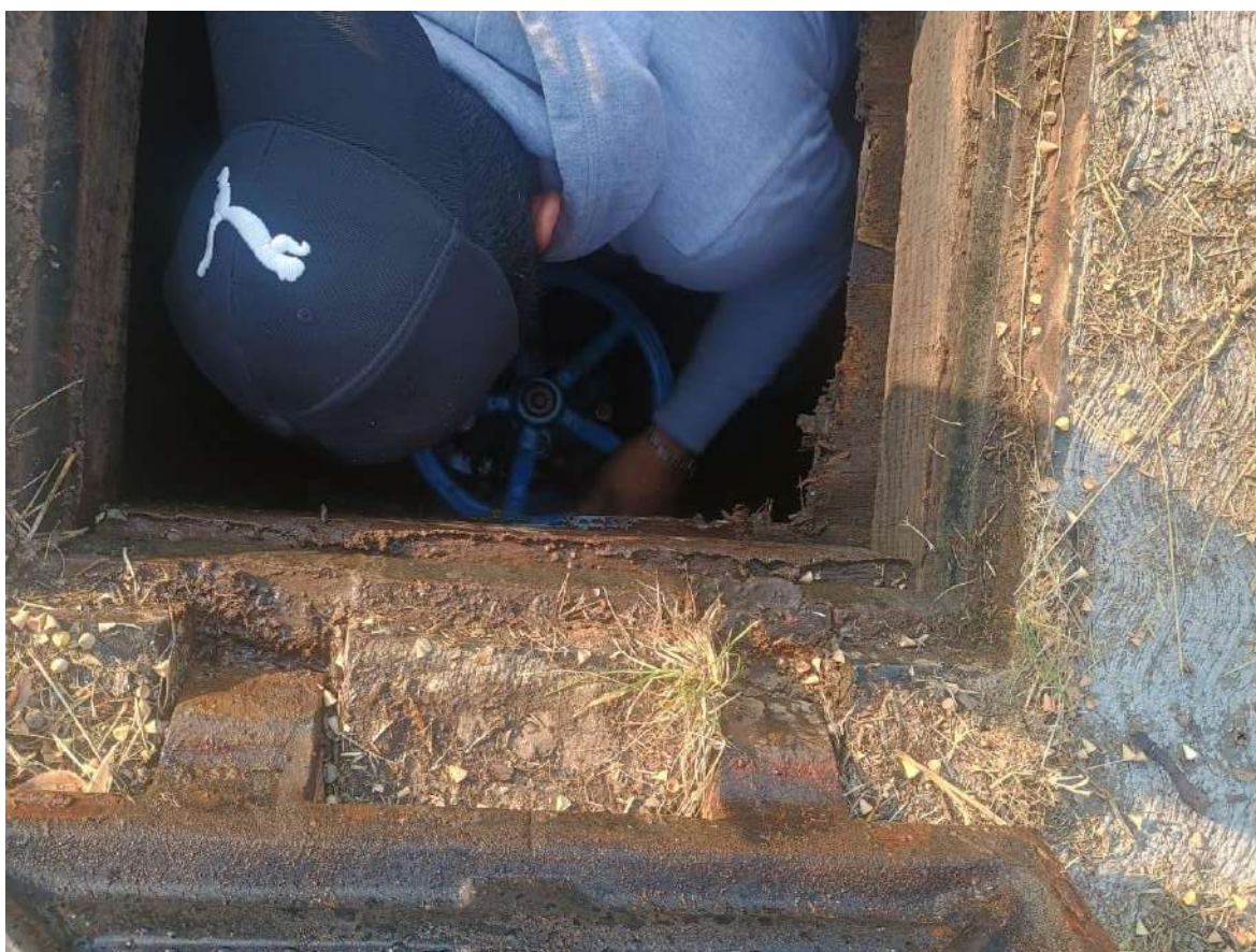
Ilustración 3 Apertura de válvula para el llenado de cisterna
